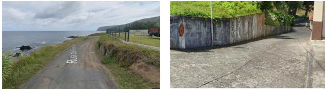
FIGURA 5.10 – EXEMPLO DE PAVIMENTOS EM MAU ESTADO
